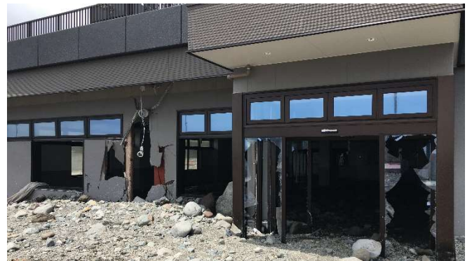
《被災した小田原漁港の交流施設》
